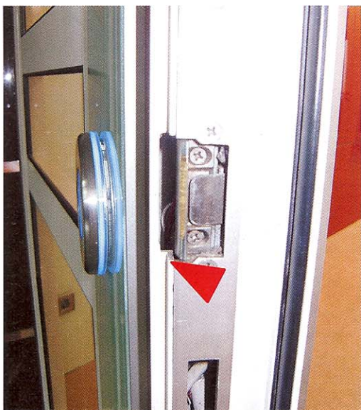
Insbesondere der nachträgliche, an bereits eingebauten Feuerschutzabschlüssen, vorgenommene Einbau eines elektrischen Türöffners, führt in der Regel zum Verlust der bauaufsichtlichen Zulassung. Nicht zulässig (Pfeil): Das Türprofil für den nachträglichen Einbau eines elektrischen Türöffners ist erheblich verletzt. (Bild: Rutenhofer).
